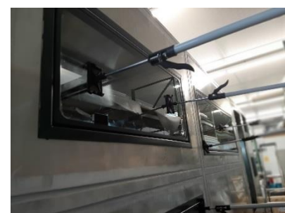
Afbeelding 7 Het raam wordt tijdens het droogproces in de wand gedrukt door steunen.
